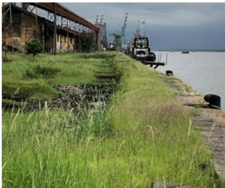
Figura 5 – Patologias no cais do antigo armazém 12.
